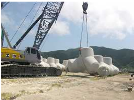
消波ブロック転置状況 コンクリートの強度が出たら、型枠を取り外し船に積み込みが出来るよう動かします。
