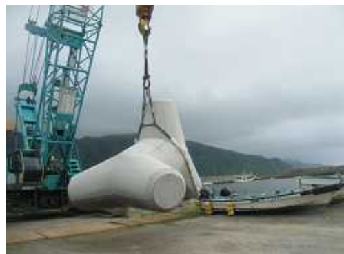
ブロック転置状況 コンクリートの強度が出たら、型枠を取り外し 船に積み込み出来るよう動かします。
