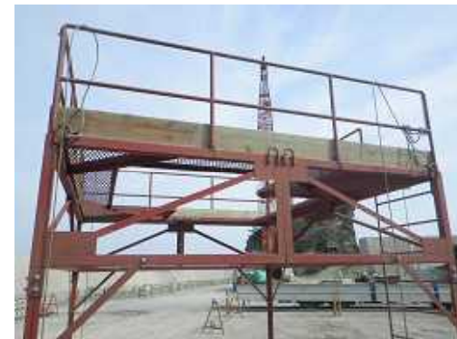
ブロック製作状況 ブロック形状を考慮し、打設用足場を製作し、安全に作業をしています。
